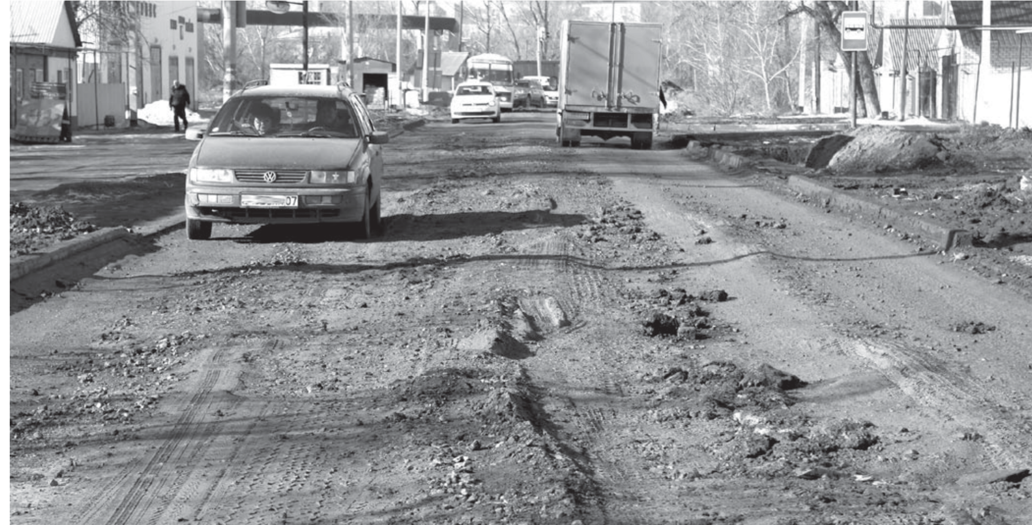
Первый этап ремонта автодороги по улице Шубина завершился в прошлом году. Но уже этой весной на дороге образовались ямы и выбоины. Улицу снова закрыли.
